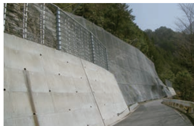
木沢上那賀線(落石対策)
