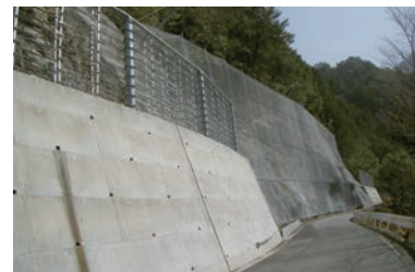
木沢上那賀線(落石対策)
